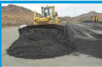
Exemple de résidus « dry stack » (% solide de 85%)
